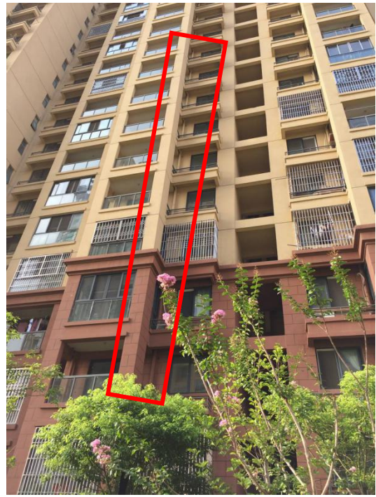
住宅楼雨水管道
