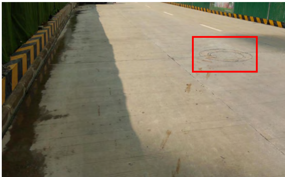
图 4-2 振兴路污水排口
