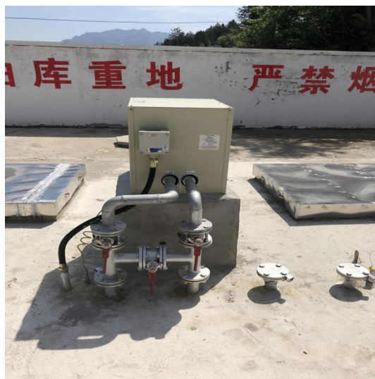
油气回收设施
